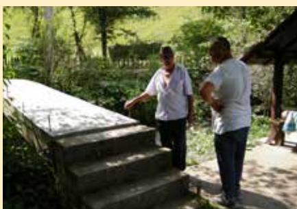
Brug zonder balustrade
